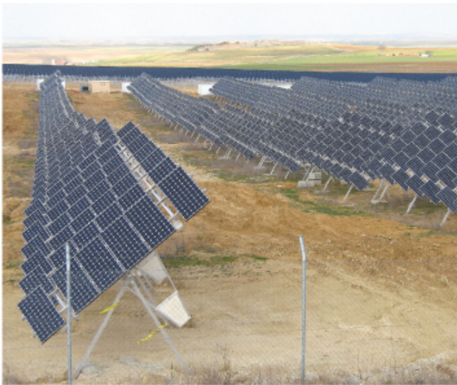
2,1 MW sobre seguidores en Peleas de Abajo (Zamora)
