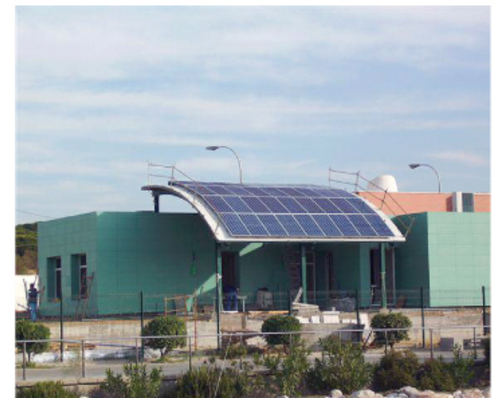
6,12 kW sobre cubierta curvada en el Punto de información del Parque Natural La Breña y Marismas en Barbate (Cádiz)
