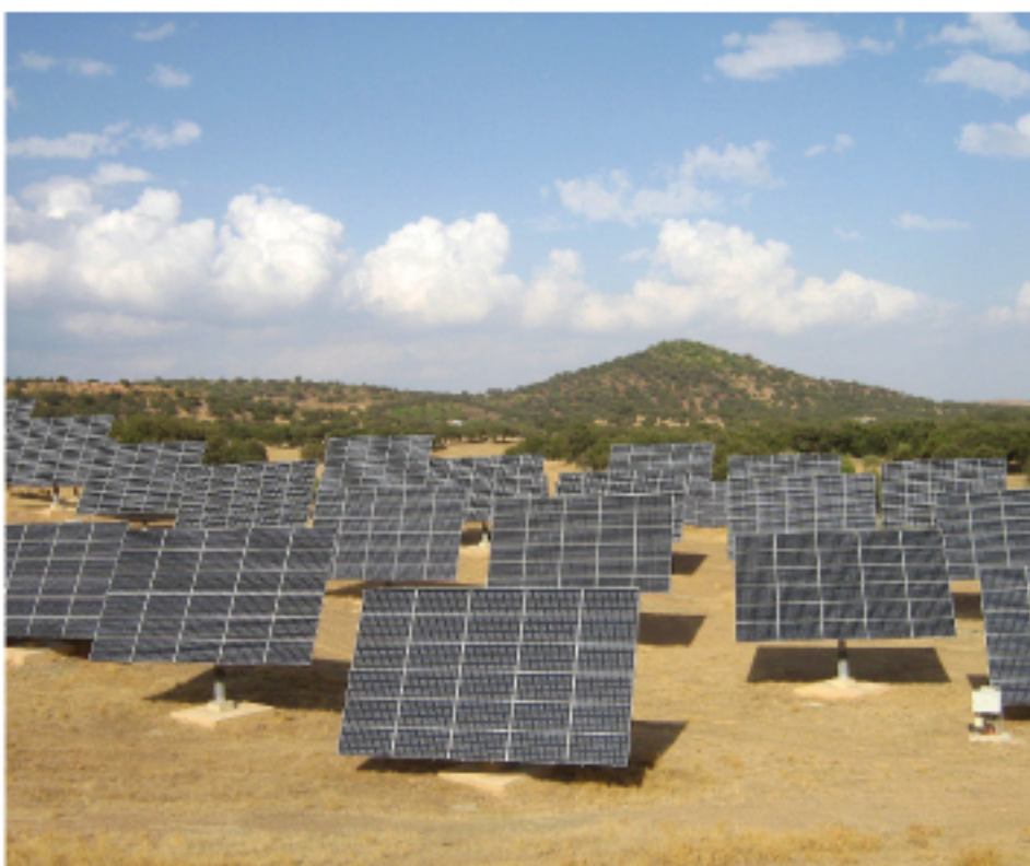
400 kW sobre seguidores de Alosno (Huelva)
