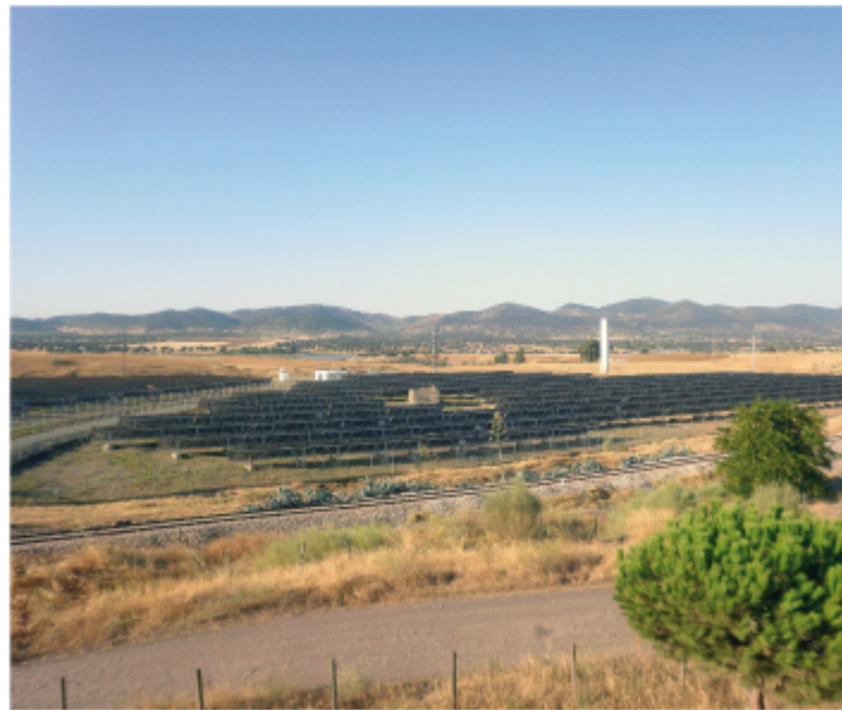
1,7 MW sobre terreno en estructura fija en Peñarroyo-Pueblonuevo (Córdoba)
