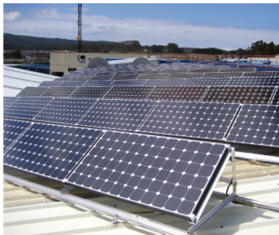
23,52 kW sobre cubierta de nave en Narón (A Coruña)
