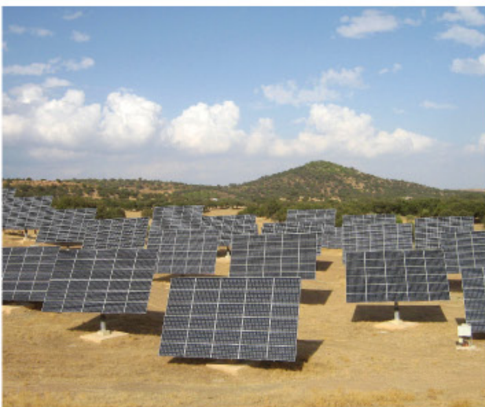
400 kW sobre seguidores de Alosno (Huelva)
