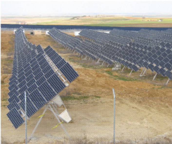
2,1 MW sobre seguidores en Peleas de Abajo (Zamora)
