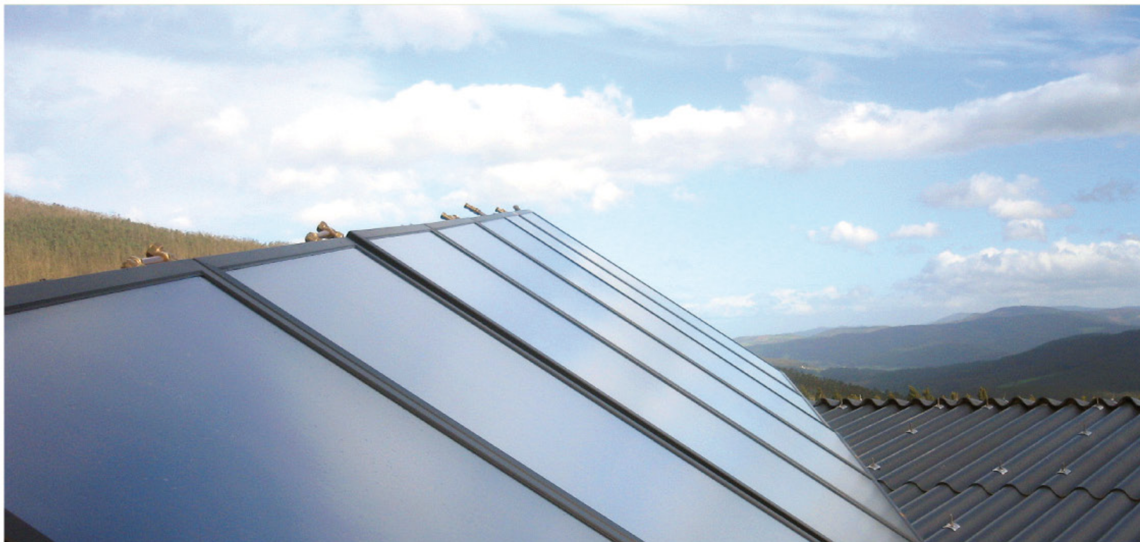
Instalación solar térmica de 32m 2 de superficie de captación para ACS en Ribadeo (Lugo)
